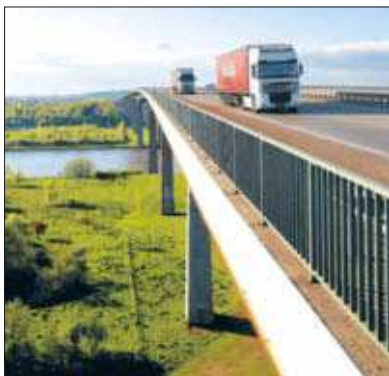
Die Rader Hochbrücke im Zuge der A 7 bröckelt gefährlich.
