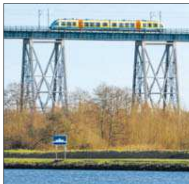
Die Rendsburger Eisenbahnhochbrücke ist ein Sanierungsfall.
